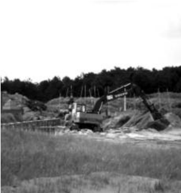
Elektrokabel nach Helgoland
